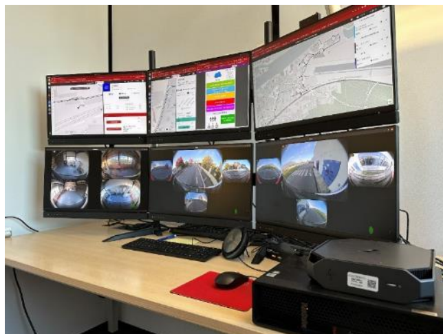
Le poste de supervision avec les caméras des navettes allumées.
